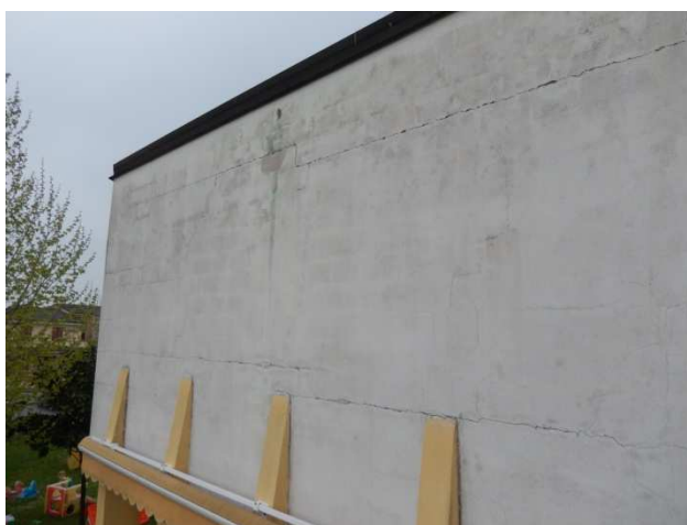
Figura 9 - Particolare delle fessure su muratura di tamponamento. Le fessure riguardano giunti in malta e l'interfaccia con le strutture in c.a.
