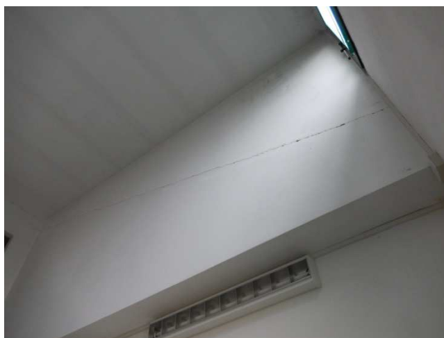
Figura 3 - L'effetto fantasma sulla copertura di uno degli abbaini. La fessurazione tra trave e muratura.
