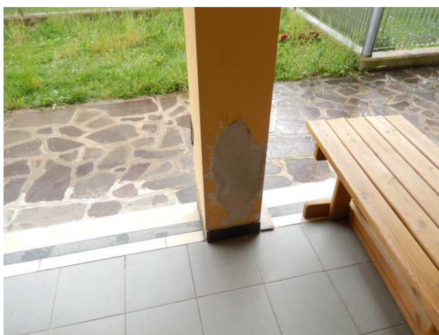
Figura 4 - Umidità alla base dei pilastri del porticato. Tale fenomeno interessa pure alcuni pilastri di perimetro
