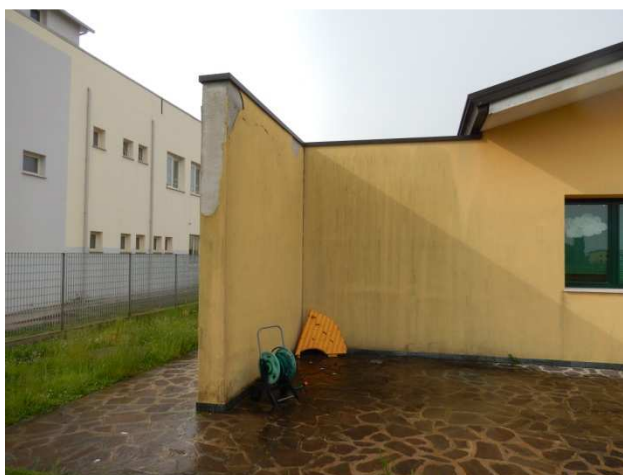
Figura 5 - Particolare delle muratura aggettante, non ammorsata alla struttura e con fessura passante all'intersezione con il corpo principale di fabbrica
