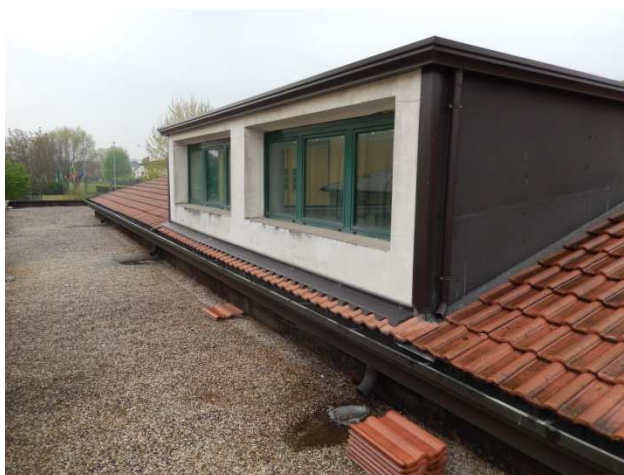
Figura 8 - Una vista della copertura piana con zone di ristagno dell'acqua
