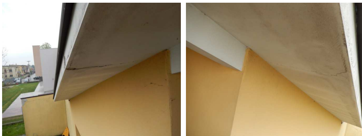
Figura 6 - Fessure importanti sulla gronda sopra il balcone sopra la mensa da ripristinare.
