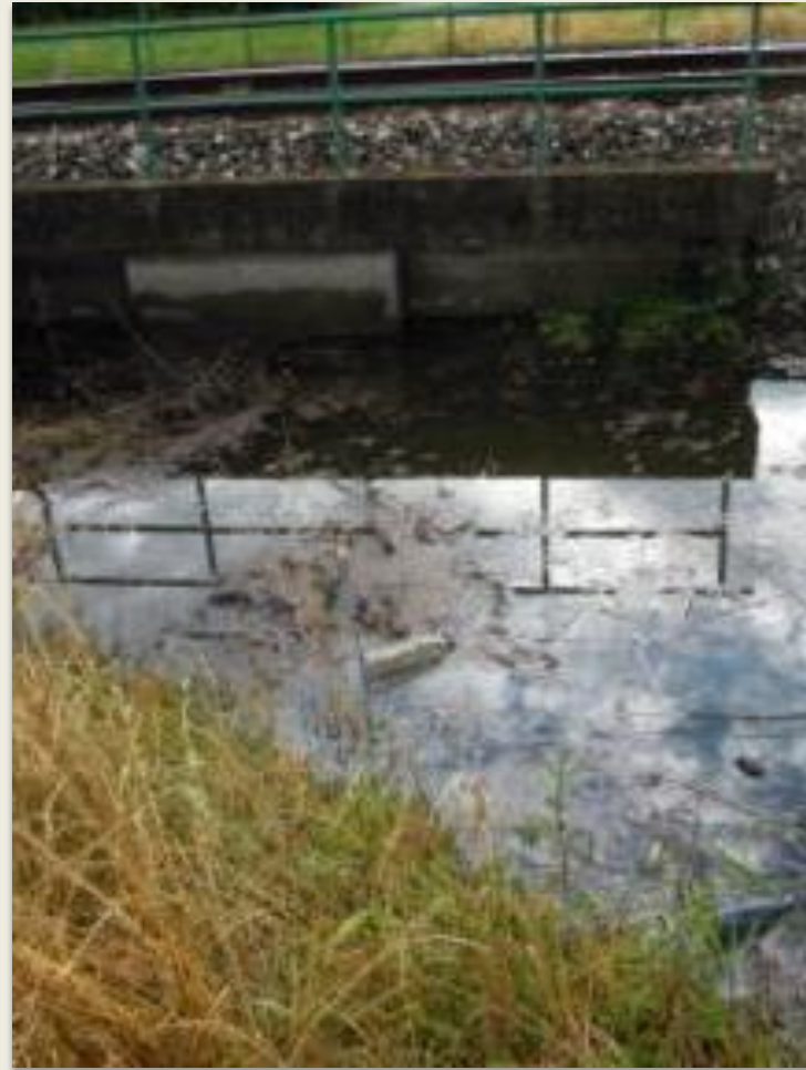
VI. Passo carraio, l'acqua rasenta i binari
